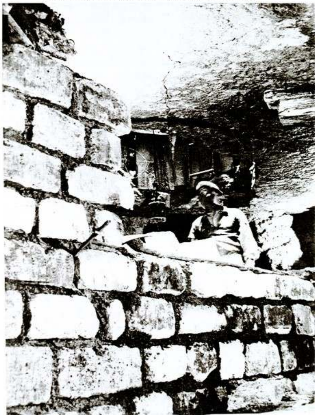
CONSTRUCTION EN 1943 DES ABRIS POUR LA DÉFENSE PASSIVE HÔPITAL COCHIN NORD (Cliché IDC)
